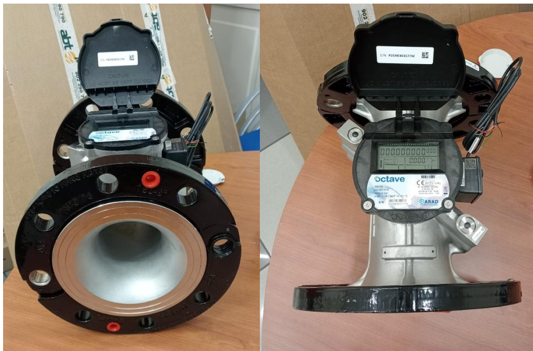
Figura 11. Contador de cabecera
